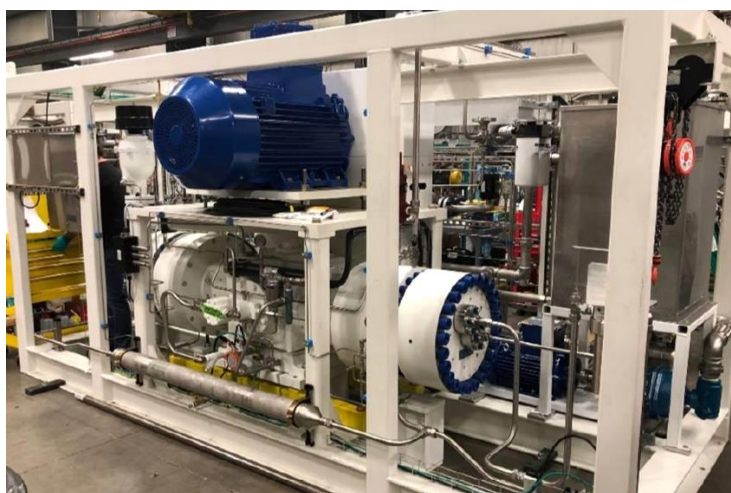
Figura 4 - Unidade de compressão
